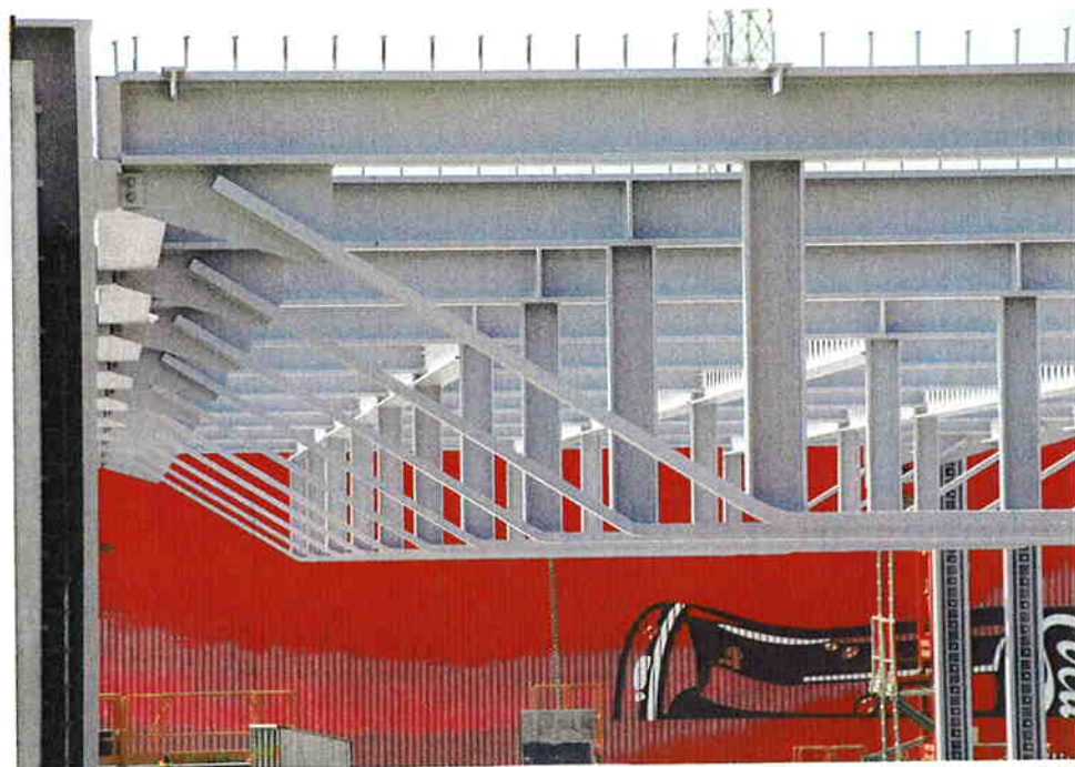
1-2 Le montage de la structure métallique, aujourd'hui terminé, s'est révélé impressionnant par la dimension même des éléments ainsi que par la rapidité de la mise en place.
