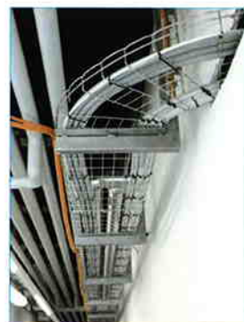
Le chemin de câbles Cablofil dans l'usine Nespresso à Avenches
